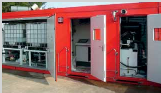
Установка хим добавок в контейнерном исполнении
