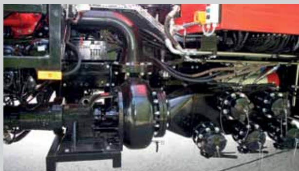
Трубопроводы и центробежный насос
